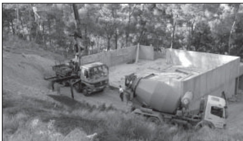
Area donde se ubicará el Auditorio Municipal, y estado de las obras
